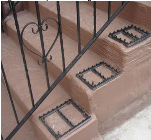
Figura 3 – Espetos nos degraus da escada
