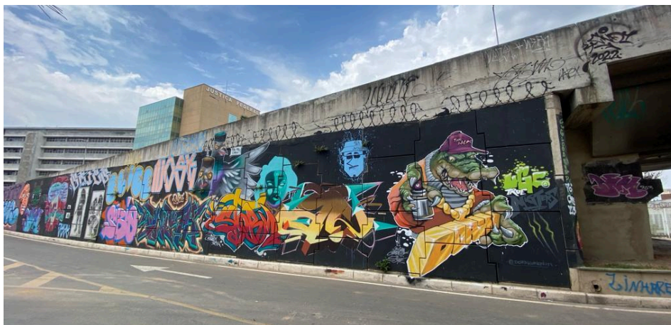
Figura 03 - Grffiti na lateral do Viaduto Hélio Fádel Araújo, no Centro de Juiz de Fora.
