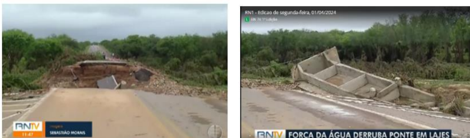
Imagem 1 – Ponte derrubada pelas fortes chuvas.
