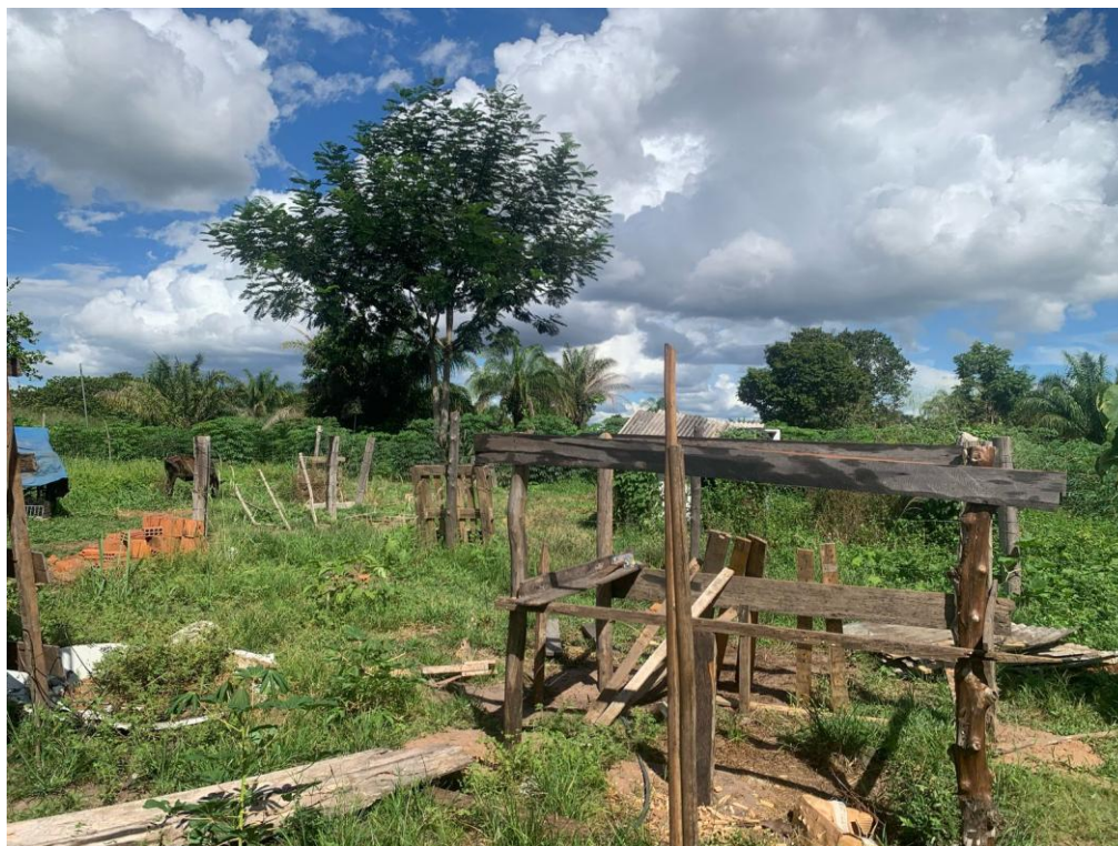
Figura 2 – Condições precárias da infraestrutura em Nova Olímpia-MT.
